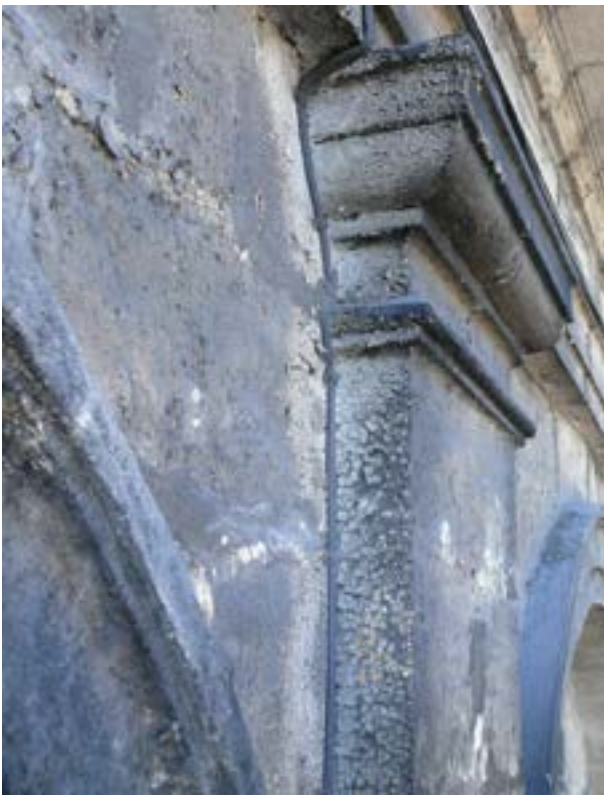
fig. 9. - Etat des parements avant travaux.
