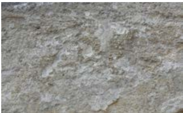
fig. 12. - Traces du badigeon blanc d'origine, suite à la dépose d'éléments rapportés en façade au XIXe siècle.
